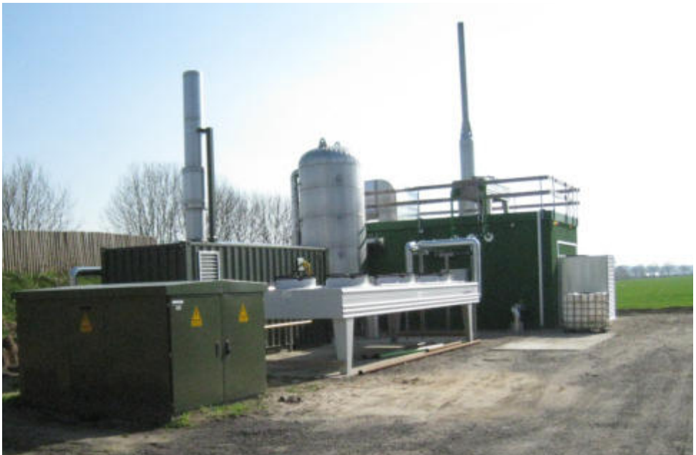
Ein Bild aus dem Jahr 2012. Es zeigt in der Mitte den Container der Heizhütte mit dem Spitzenlast-Gaskessel und dem Wärmespeicher dahinter. Vor dem Container der Stromtransformator und der Tischkühler des BHKW. Hinten steht das erste BHKW, das mittlerweile durch ein größeres ersetzt wurde.
